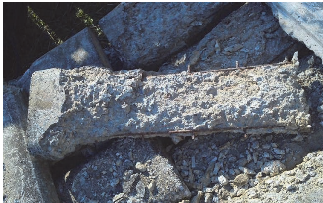
写真1 コンクリートの剥離、鉄筋の露出（中性化又は塩害）
