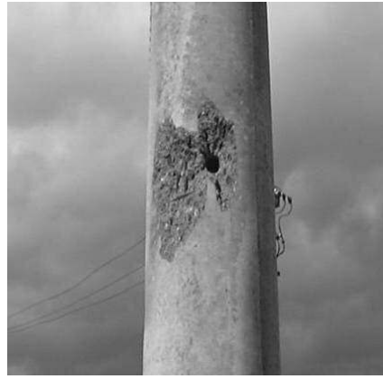
足場ボルト引っ掛け跡
