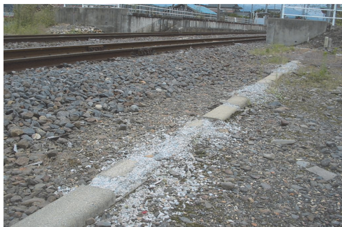
写真2 コンクリートの剥離、ポップアウト（凍害）
